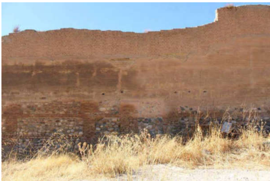
Figura 2.33. Vista a extramuros del portillo cegado durante la intervención de A. Jiménez Torrecillas, 2005. S. Peñalver Martín, 2022.
