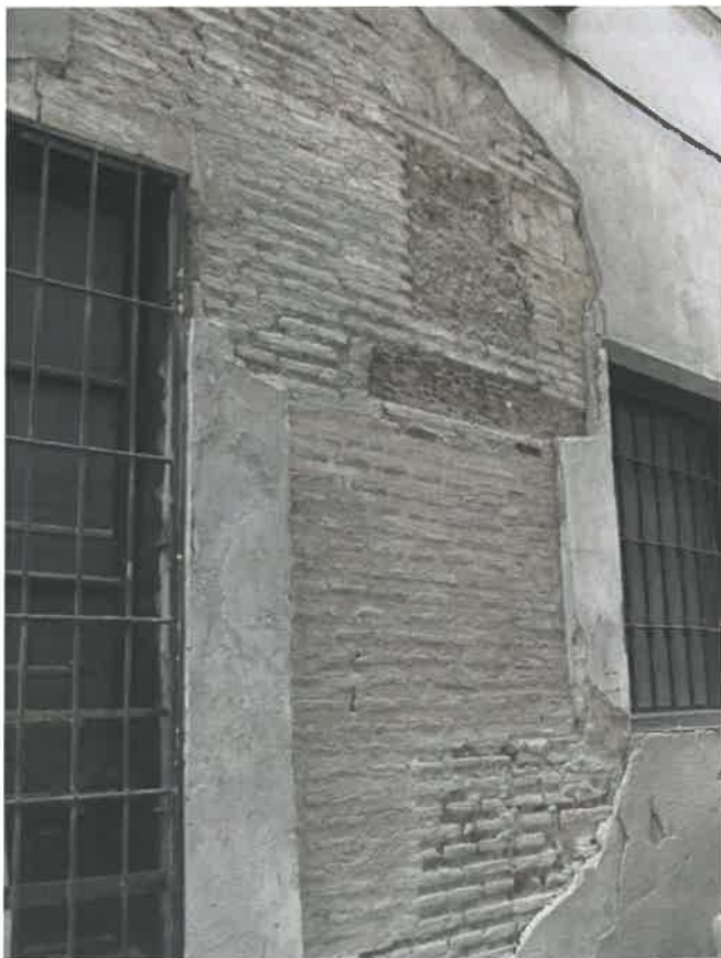
DETALLES DE ALTERACIONES PRODUCIDAS EN LOS HUECOS DE LA FACHADA
