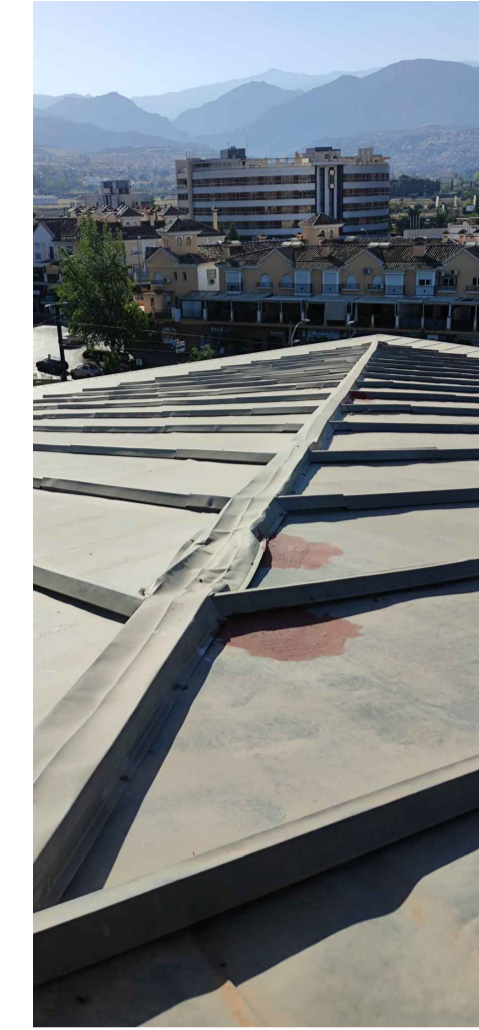
Imagen del estado actual de la cubierta de zinc
