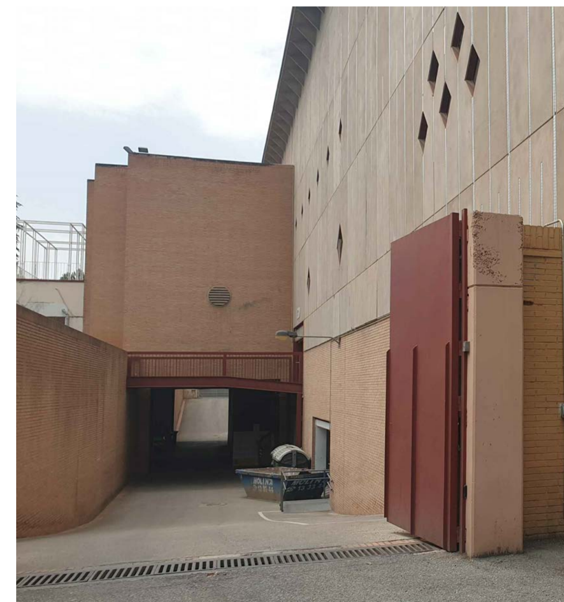
Rampa a sótano : colocar barandilla a ambos lado y sustituir el sumidero
