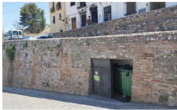
Ilustración 15. Carril de la Lona. Módulos empotrados.
