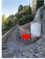
Ilustración 25. Calle Cruz de Quirós. Módulo semiempotrado en muro de contención existente entre viales.
