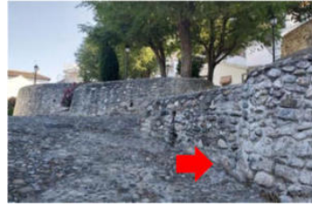
Ilustración 20. Placeta de Liñán. Módulo semiempotrado en muro de contención de espacio libre público y acerado.
